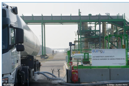
Chargement de camion-citerne en GNL au terminal de Montoir Photo : ELENGY
